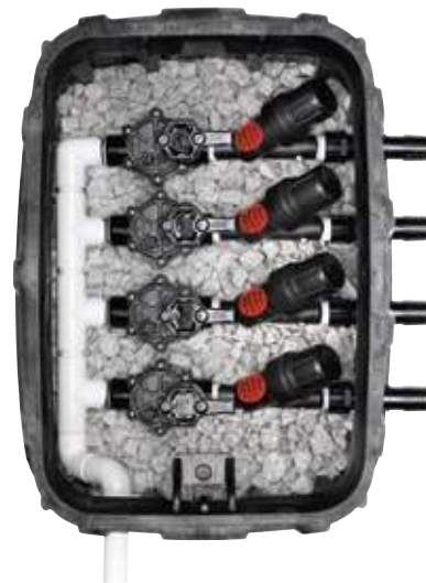
Cuatro kits de control de zona en una caja de válvulas estándar.
